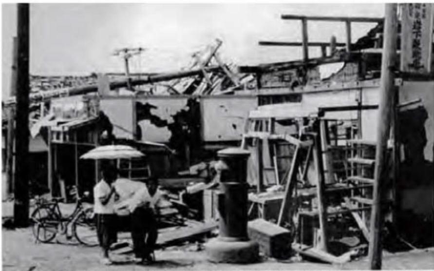
屋根を吹き飛ばされた家（甲府市・昭和34年） 山梨大学前の惨状。屋根は吹き飛ばされ、壁は打ち破られており、暴風雨の猛烈さが伝わってくる。台風のスPEEDが速すぎて防災対策が間に合わなかったこともあり、未曾有の大災害となった。
